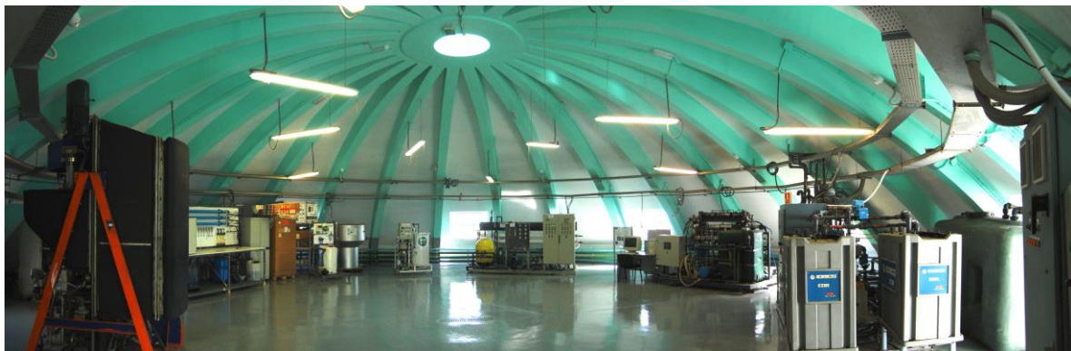
Desalination dome. ITC facilities in Pozo Izquierdo
